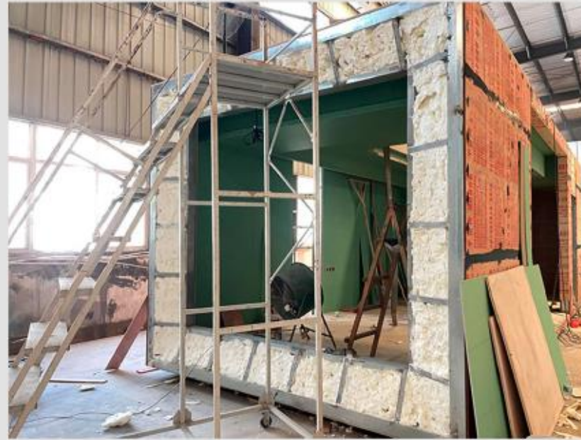
Aislamiento de poliuretano
